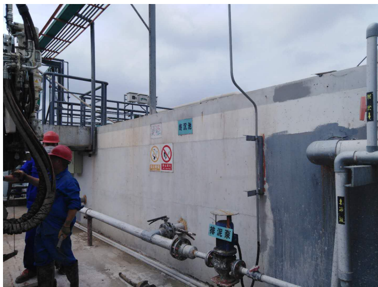
图 4-8 污水处理区终沉池
