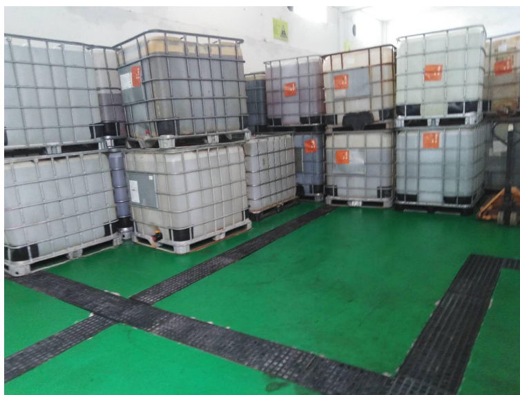
图 4-10 危废仓库地面情况
