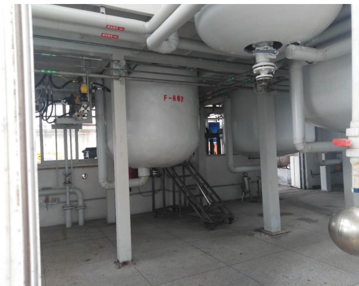
图 4-12 氢化车间内部情况
